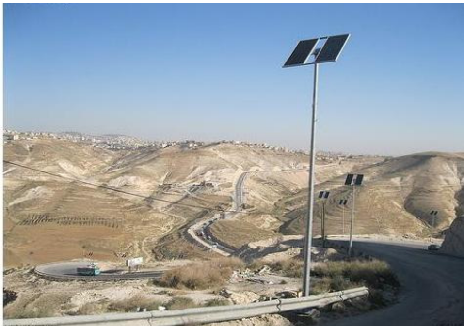
Εικόνα 5.3 Τοποθεσία φωτοβολταϊκού συστήματος στην οδό Ουάντ Εννάρ νότια της Δυτικής Όχθης.
