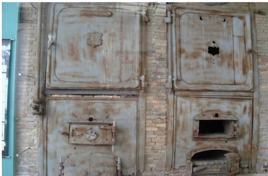
Εικόνα 3 Οι ατμολέβητες Babcock & Wilcox
